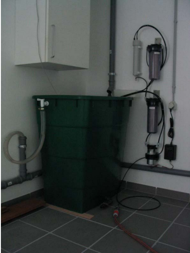
Gesamtansicht (Leitungswasserspeisung noch provisorisch)
