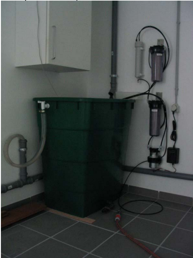
Gesamtansicht (Leitungswasserspeisung noch provisorisch)
